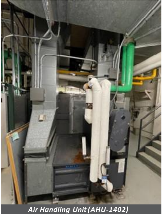
Air Handling Unit (AHU-1402)
